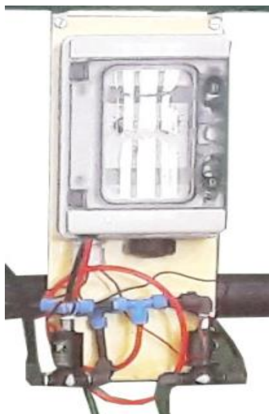
Рис.7. Блок управления автоматическим песчано-гравийным фильтром
